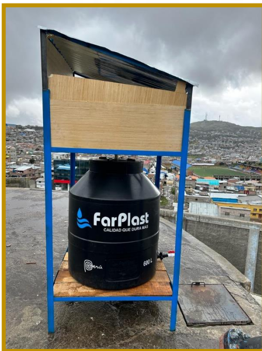
SISTEMA DE RE-CLORACIÓN RESERVORIO
