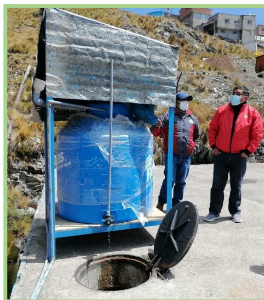
SISTEMA DE RE-CLORACIÓN RESERVORIO RECTANGULAR SAN JUAN
