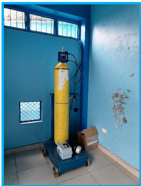
SISTEMA DE RE-CLORACIÓN RESERVORIO COLUMNA PASCO
