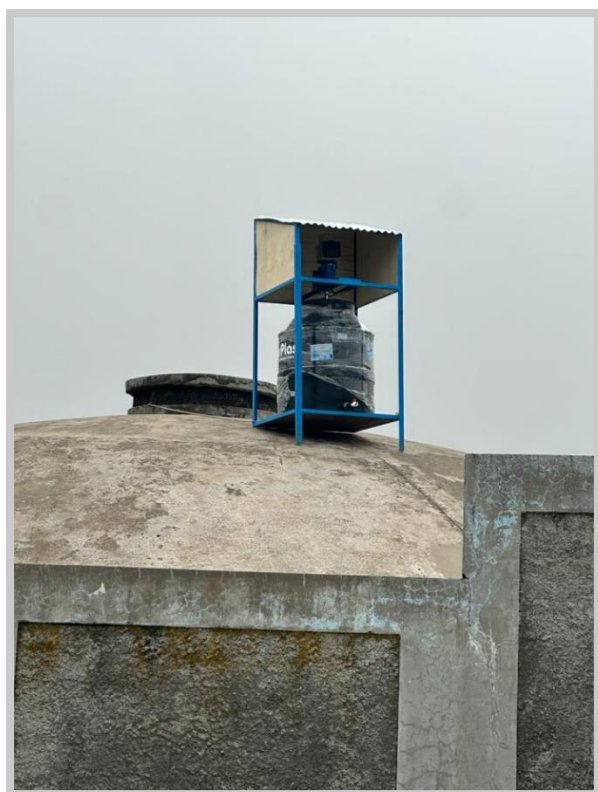
SISTEMA DE RE-CLORACIÓN RESERVORIO CRUZ BLANCA
