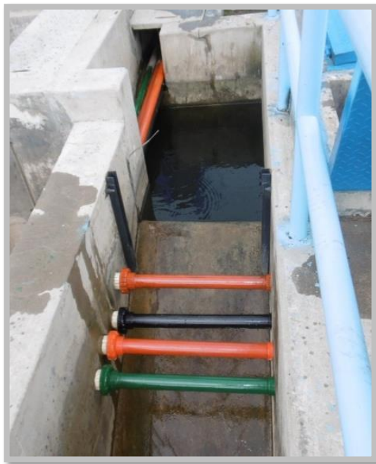
* Cámara de repartición y mezcla
