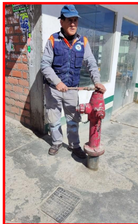
*Grifo contra incendio en la Localidad de Pasco – Distrito de Yanacancha.
