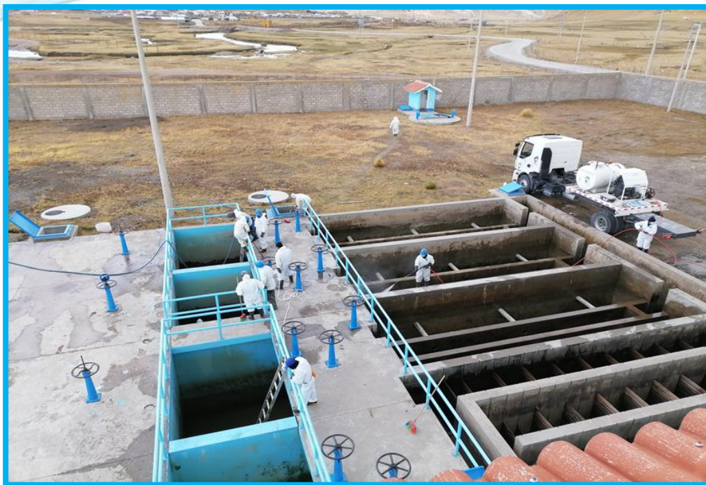
* Planta de tratamiento de agua potable Yurajhuanca – Junio 2023
