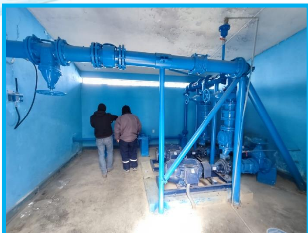
ESTACIÓN DE REBOMBEO HUANCAPUCRO
