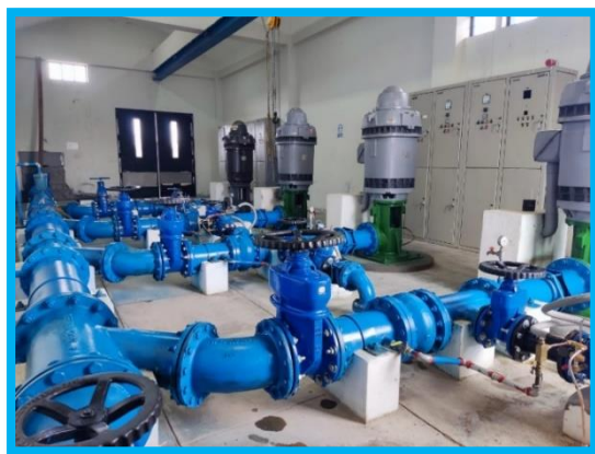
ESTACIÓN DE BOMBEO YURAJHUANCA
