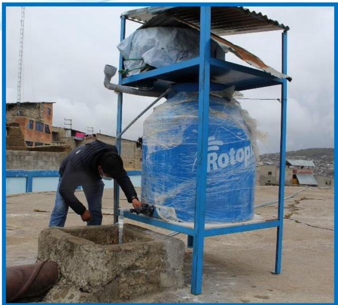
SISTEMA DE RE-CLORACIÓN RESERVORIO HUANCAPUCRO
