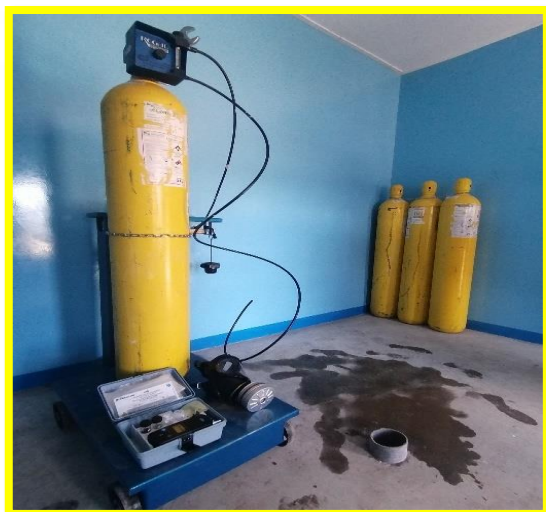
SISTEMA DE CLORACIÓN RESERVORIO TUPAC AMARU
