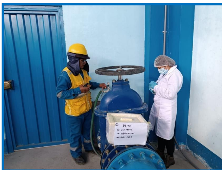
*Control de calidad en el PUNTO DE SALIDA de la PTAP ULICHIN.
