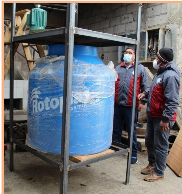
SISTEMA DE RE-CLORACIÓN ESTACIÓN DE RE-BOMBEO GARGA
