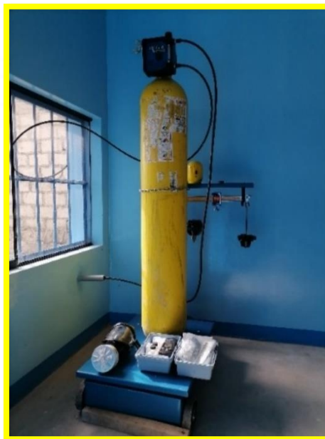
SISTEMA DE CLORACIÓN DE RESERVORIO 03 DE AGOSTO
